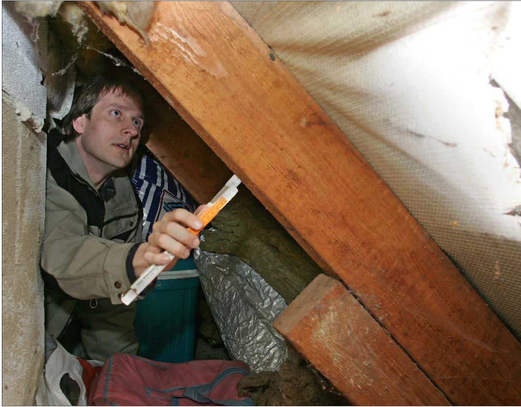
Blick in die Abseite: Das darunter liegende Zimmer ist meist nicht vor Wärmeverlust in diesem Randbereich geschützt. Hartens Rat: „einfach Mineralwolle oder Styropor auslegen – das geht leicht und ist billig“. Aber die unter den Dachpfannen gespannte Folie muss vorhanden und dicht sein – sonst wird jede Dämmung feucht.
